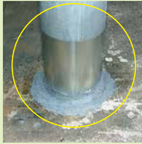
鋼製街灯地際部
