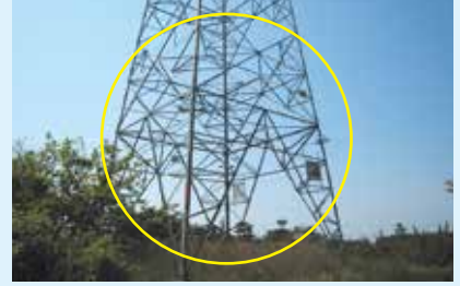
送電鉄塔本体
