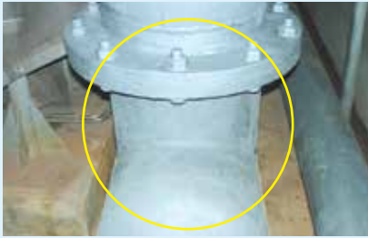
地下設備内配管
