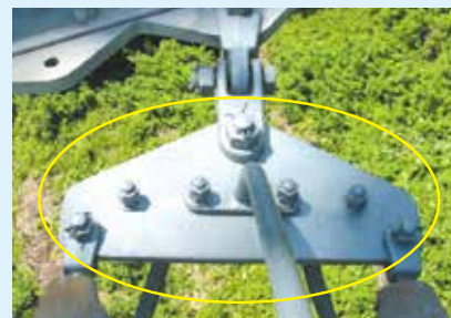
送電架線金物
