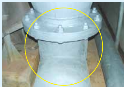
地下設備内配管
